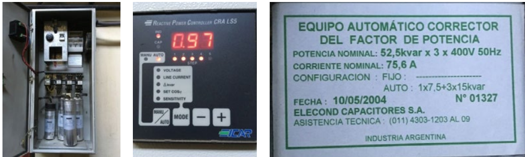
Imagen 25: Banco de capacitores. (Fuente: ADIMRA)
