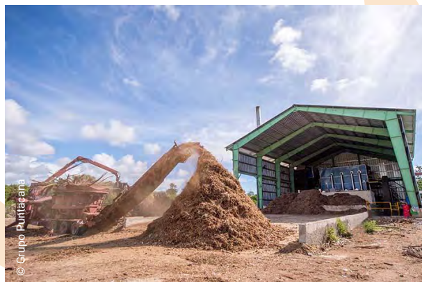
La chaudière à biomasse de la blanchisserie de Punta Cana .
